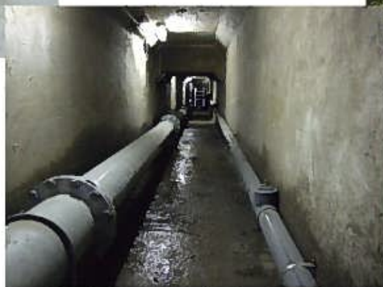
地下通路 圧送管
